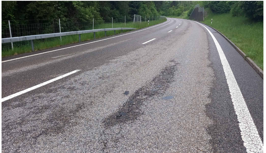
Wird bald abgefräst und ersetzt: Der Deckbelag der Umfahrungsstrasse. Foto: zVg
